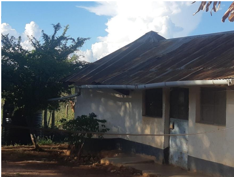
Abbildung 13: Beispiel für eine Dachrinne, die das Wasser vom Dach zum Tank leitet
